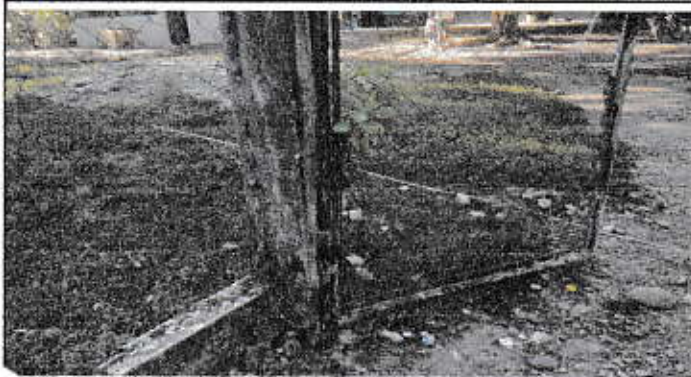
Foto 1: Porton principal del centro educativo averiado por el paso de los años.
