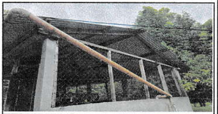
Foto 6: La estructura es de madera ya se encuentra dañada.
