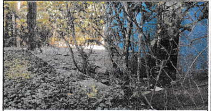
Foto 2: Deterioro de la malla perimetral por óxido y tiempo de uso.
