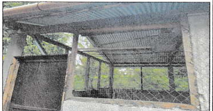
Foto 4: Costaneras del techo de la cocina en mal estado
